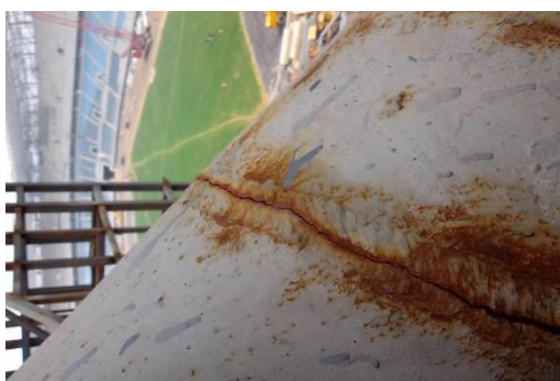
图 5.12-1 局部焊缝开裂
